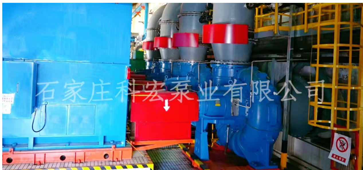
📍 C900KT陶瓷泵应用于宁夏某电厂1060MW机组脱硫项目
