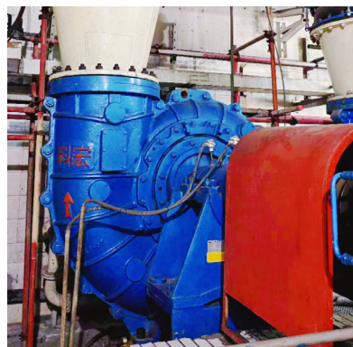
📍 C600KT陶瓷泵应用于内蒙古某电厂脱硫工况
