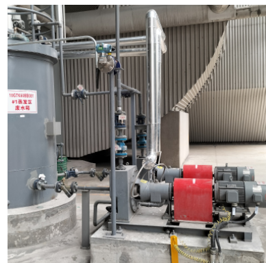
📍 C40KT陶瓷泵应用于江苏某电厂废水零排放系统
