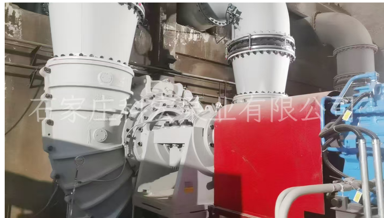
📍 C1000KT陶瓷泵应用于河南某电厂2×630MW机组脱硫项目
