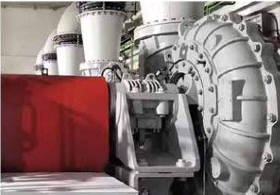
C800KT河北某电厂脱硫项目
