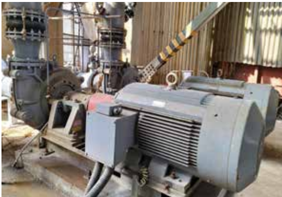
江苏某电厂废水处理项目
