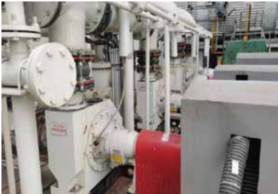
C200KT江苏某电厂废水处理项目
